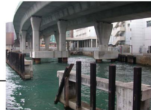
紅磡繞道防撞欄樁柱
