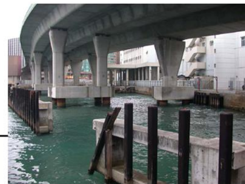
紅磡繞道防撞欄樁柱
